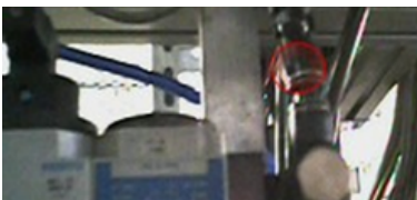
Zdroj: SUSPA CZ s.r.o., foto pořízené přístrojem Testo Senzor LD Pro pro zjišťování úniků stlačeného vzduchu
